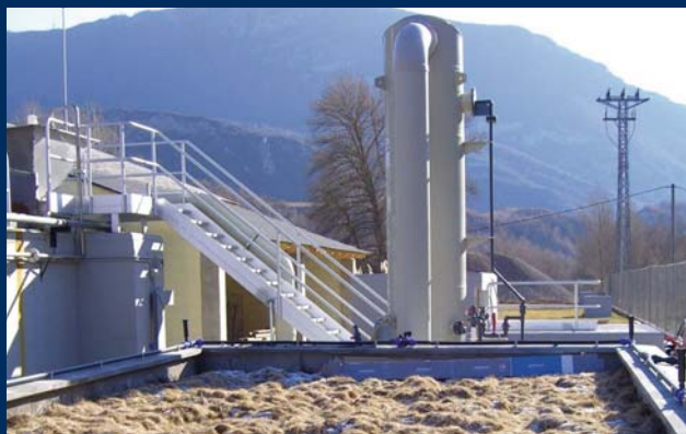
城市污水处理厂的生物滤池除臭
