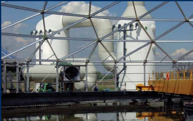
城市污水处理厂化学洗涤气味控制
