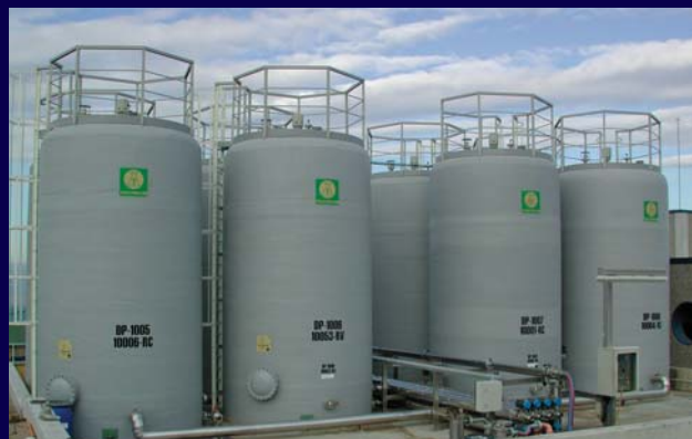
腐蚀性液体存储罐区
