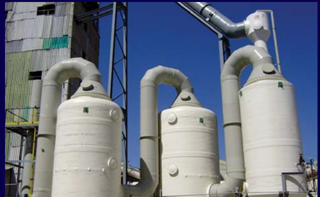
化肥工业的废气除尘净化设施
