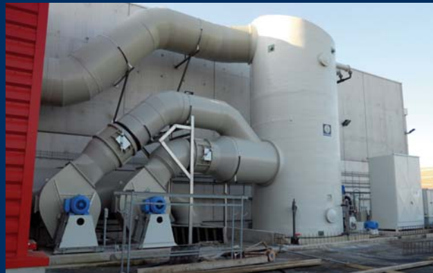
城市污水处理厂恶臭控制加湿系统
