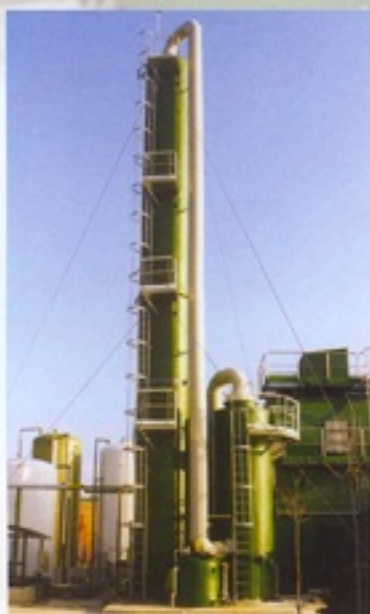
NH 3 stripping on an urban landfill Desgasado de NH 3 en vertedero municipal
