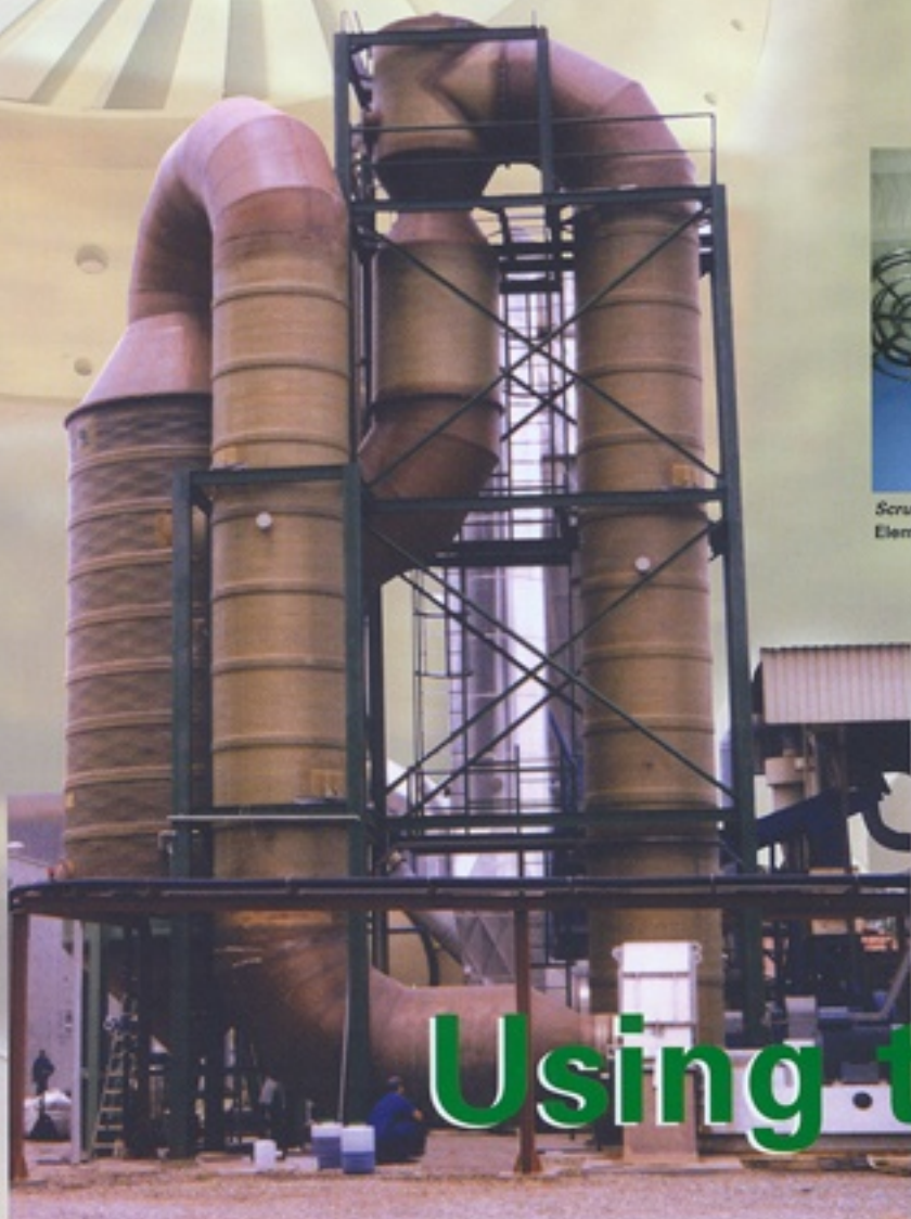
Dedusting unit (venturi-cyclon) on a liquid manure treatment plant Despolvado (venturi-ciclón) en planta de tratamiento de purines
