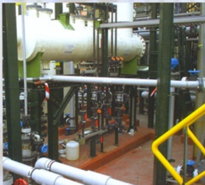
Dedusting unit by multi-venturi on a pigment manufacturing plant Despolvado por multiventuri en planta de fabricación de colorantes
