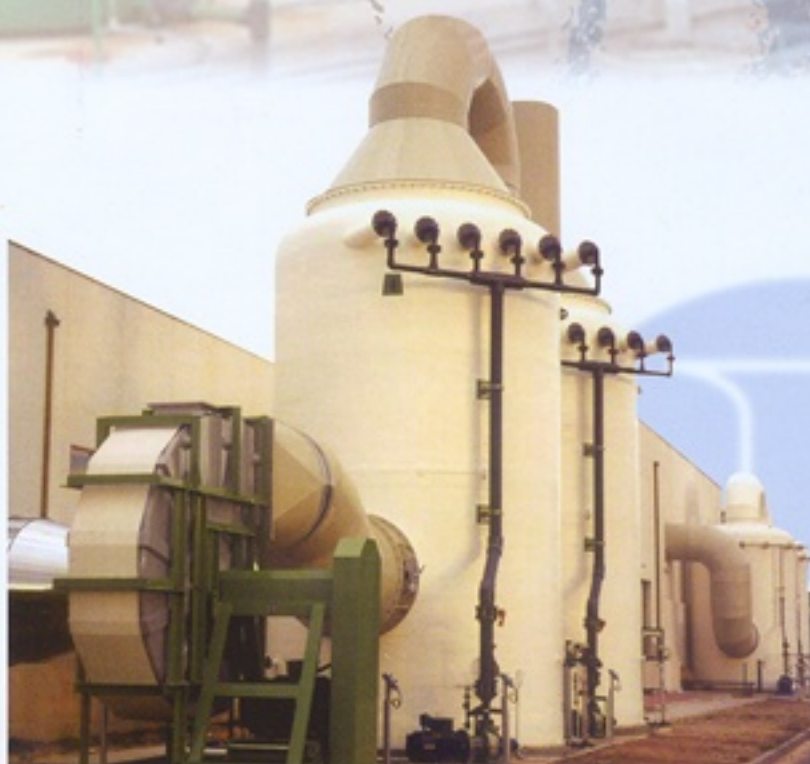
NH 3 +H 2 S+R-SH absorption on an industrial WWTP Absorción de NH 3 +H 2 S+R-SH en una EDAR Industrial
