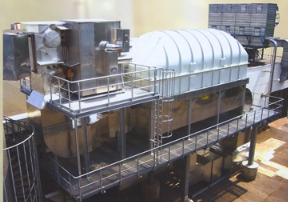
VOC thermal oxidation at a German fine chemical plant Oxidación térmica de COV en una planta alemana de química fina
