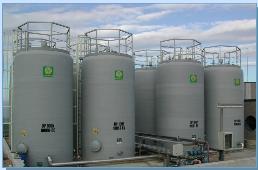
Parque de Depósitos para almacenamiento de líquidos corrosivos
