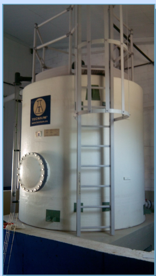
Depósito vertical para H 2 SO 4 con barandilla
