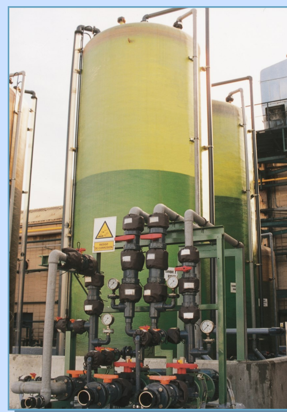
Tanques de almacenamiento HCl EN-13121
